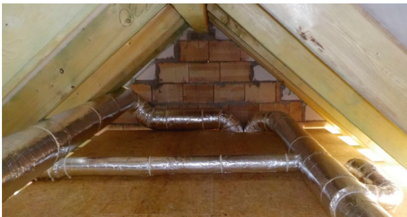
▲ Bardzo niska część strychu tuż pod kalenicą zwykle traktowana jest jako bezużyteczna. Ale to dobra przestrzeń techniczna do ukrycia rur o dużej średnicy. TOPVAC (TOPVENT)
