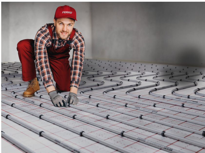
▲ Ogrzewanie podłogowe trzeba wyjątkowo starannie zaplanować, bo dokonywanie później jakichkolwiek zmian jest skrajnie trudne. FERRO
