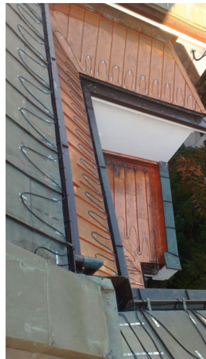
▲ Ogrzewanie przeciwooblodzeniowe na dachu można bez problemu zainstalować w użytkowanym już budynku. ELEKTRA
