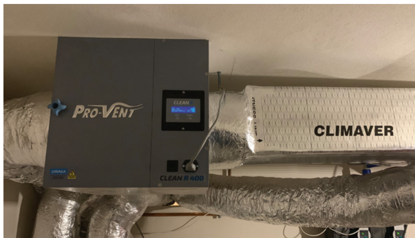
▲ Do centrali wentylacyjnej można dodać jeszcze urządzenia zapewniające bardzo dokładną filtrację powietrza trafiającego do wnętrza domu. Ma to ogromne znaczenie dla osób uczulonych np. na pyłki roślin. PRO-VENT
