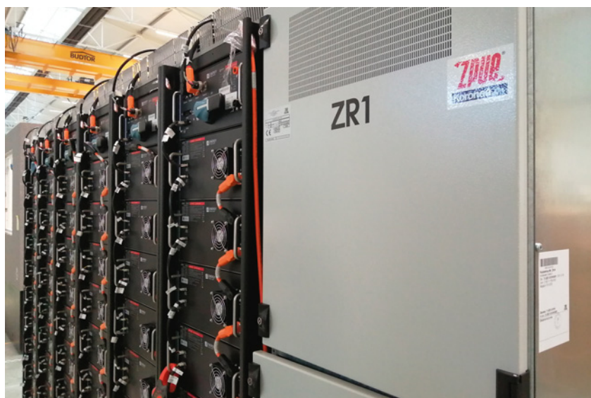
▲ Użytkownicy profesjonalni, przede wszystkim duże firmy, wykorzystują wielokrotnie większe magazyny energii, niż właściciele domów jednorodzinnych. Jednak w ich przypadku stawki za energię oraz zasady rozliczania są zupełnie inne. ZPUE KORONEA
