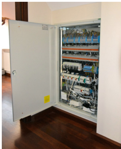
▲ Kablowa instalacja inteligentna zawiera kilometry przewodów, które grupuje się w metalowej szafie. L. JAMPOLSKA
