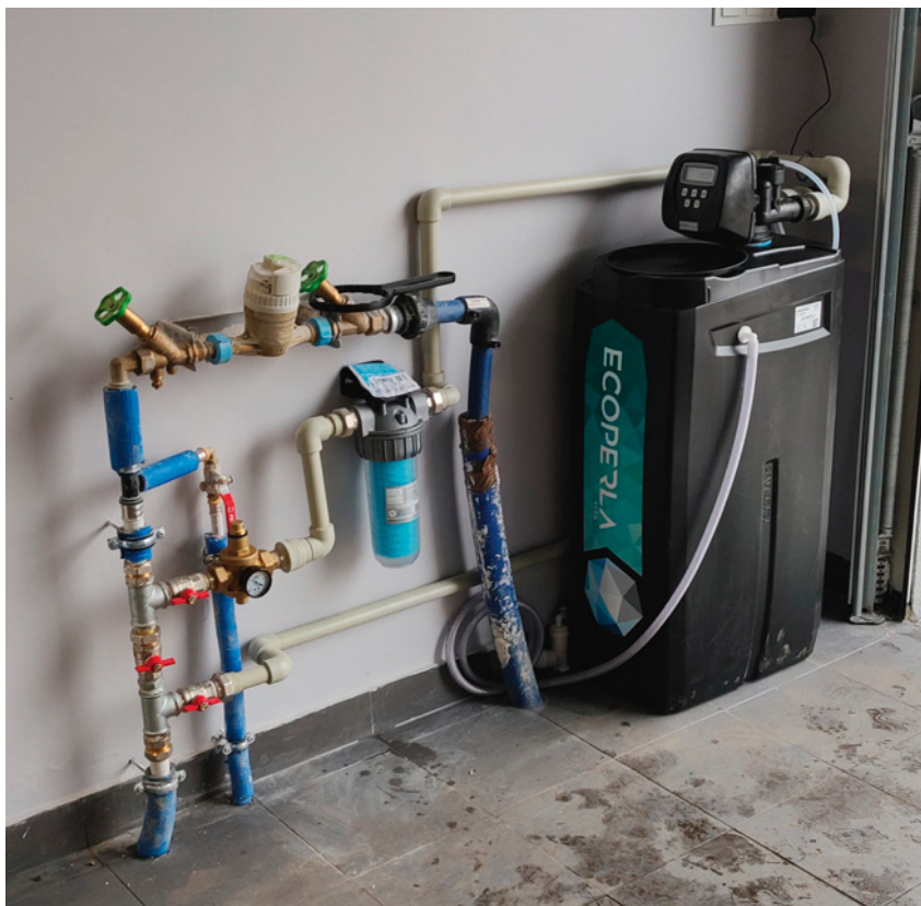
▲ Zmiękczacze wody zamontowane w garażu lub w kotłowni – do redukcji twardości wody w całym domu. Przed zmiękczaczem zamontowany filtr mechaniczny w celu redukcji zawiesin z wody. KLARSAN
