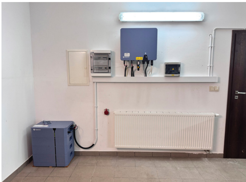
▲ Magazyn energii dodany do istniejącej instalacji PV – bez wymiany falownika. INSTALATOR LEMONENERGY.PL
